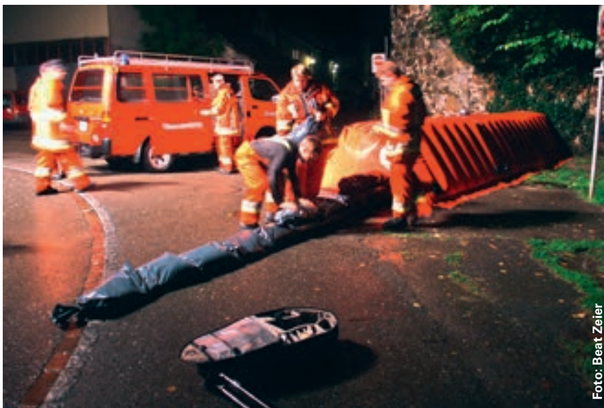
Die Feuerwehr ist immer häufiger als Wasserwehr im Einsatz. Hier baut die Feuerwehr Bremgarten im Ernstfall eine neue, mobile Hochwassersperre auf.
