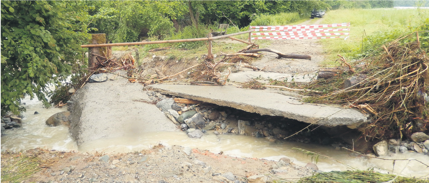
An der Mündung zur Reuss riss der Pflanzerbach die Betonbrücke weg und machte damit den Weg unpassierbar.
