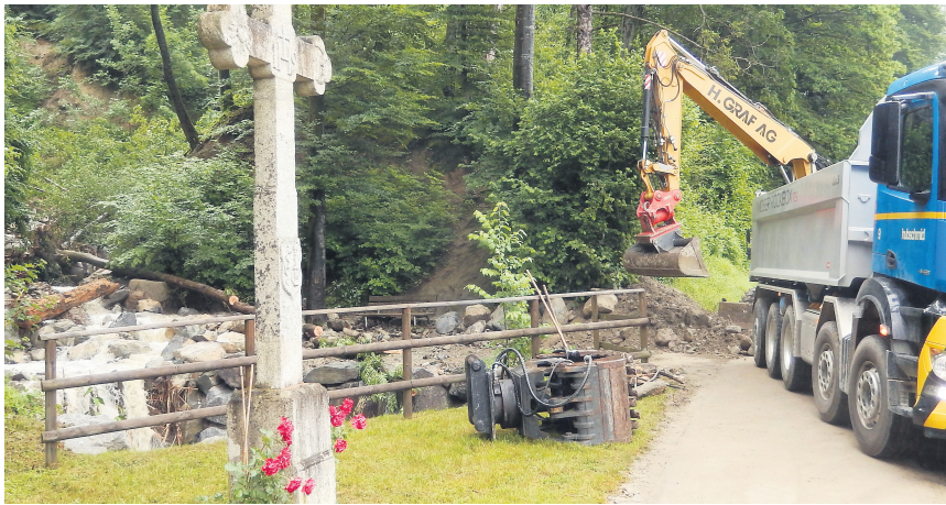
Oberhalb der Kantonsstrasse musste der Schlamm weggeräumt werden.
