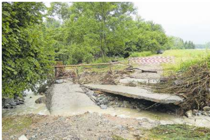
Die betonierte Reussuferwegquerung ist vom Pflanzerbach teilweise weggerissen und zerstört worden.
