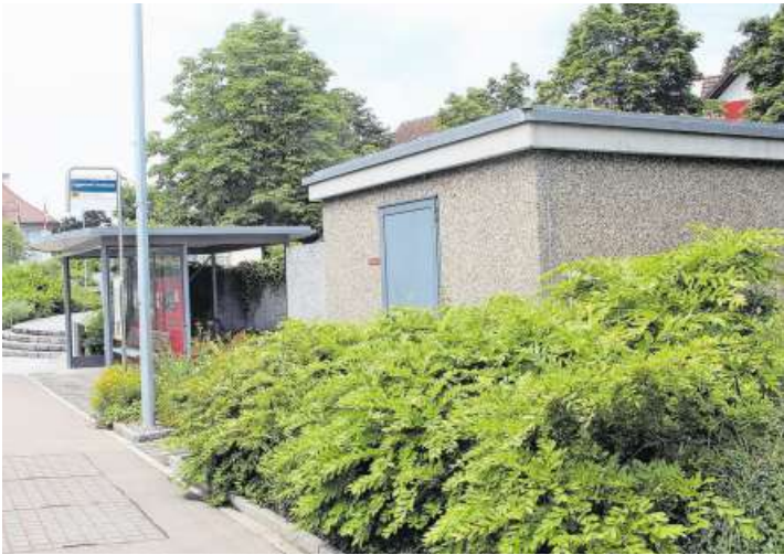
Die kleine Transformatoren-Station am Dorfplatz neben der Bushaltestelle ist das Herzstück der Elektra Eggenwil. Bild: Andrea Lim
