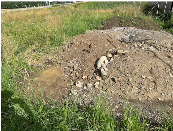
Abbildung 3: Nördlich angrenzend an S4, nahe des bestehenden Gebäudes liegt abgetragenes Material. Der Aushub geschah horizontalgetrennt, entwickelter Unterboden ist überwiegend nicht oder dann nur ansatzweise vorhanden.
