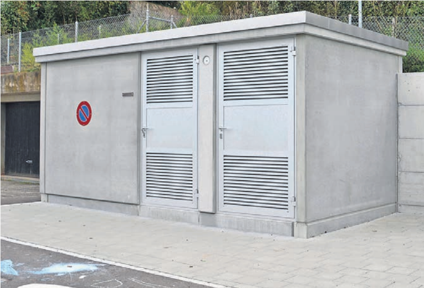
Der Gemeinderat möchte die Elektra Eggenwil inklusive der Infrastruktur an die AEW Energie AG verkaufen. Dazu zählen auch die Traföhäuschen.
