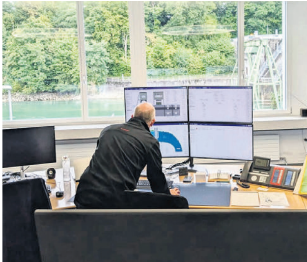
Von der Schaltzentrale aus wird das Kraftwerk rund um die Uhr überwacht. In der Nacht von einem Pikettdienst.
