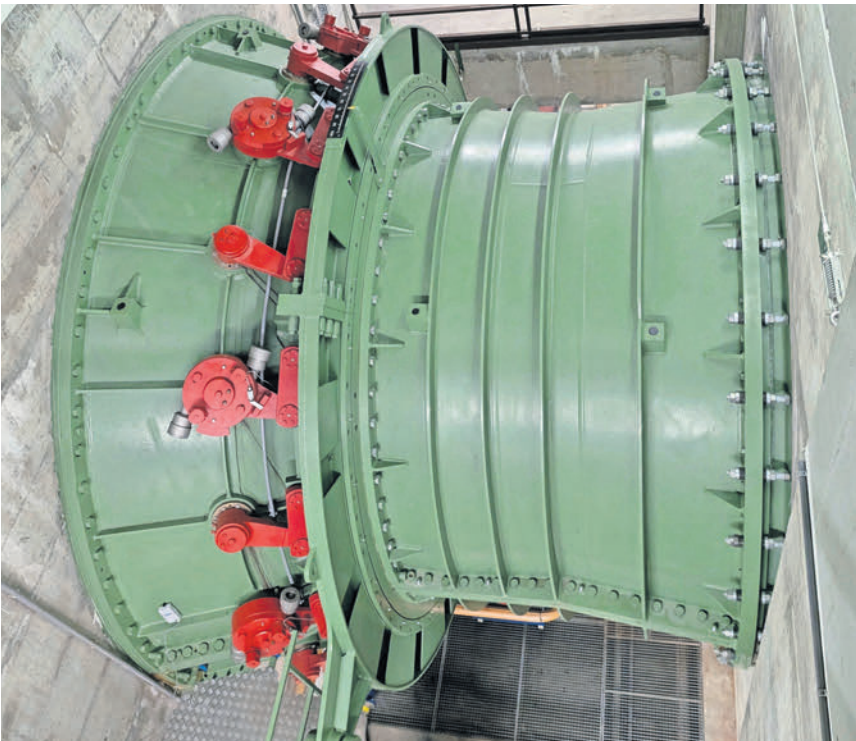
Das Herzstück der Anlage sind die zwei riesigen Turbinen.
