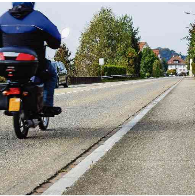
Der Belag der Badenerstrasse ist 30 Jahre alt und soll ersetzt werden. DOMINIC KOBELT
