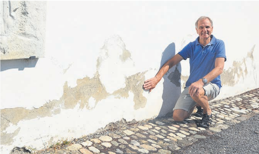
Franz Rutzer zeigt die abblätternde Farbe an der Fassade. Dies geschieht, weil die Feuchtigkeit an den Wänden nach oben steigt.
