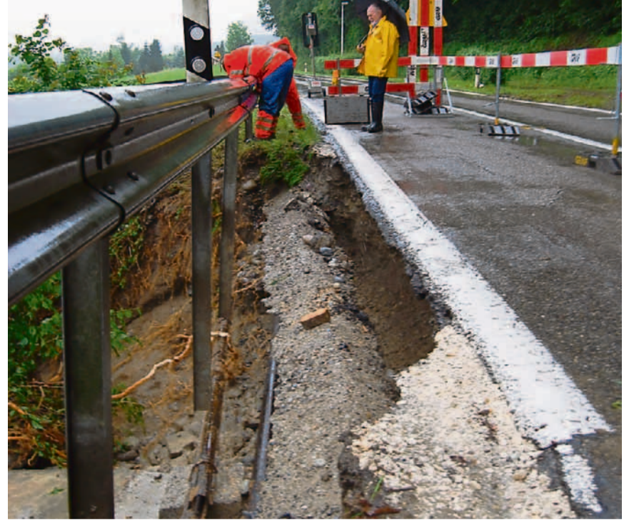
Juni 2010: Beschädigte, unterspülte Kantonsstrasse.
